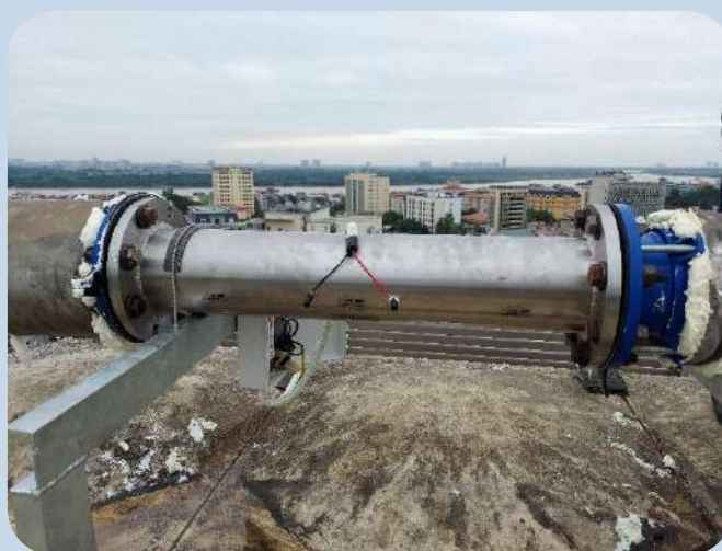
Lắp đặt tại toà nhà Sun Red River của Nhật Bản 23 Phan Chu Trinh, Hoàn Kiếm, HN
